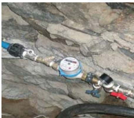
внутрішньо будинковий прилад обліку споживання
